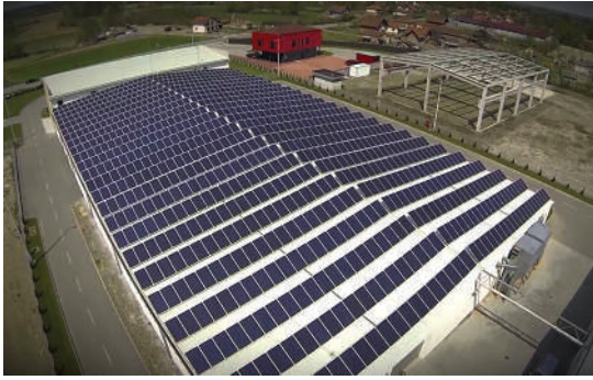
SLIKA 4. Solarna elektrana na krovu fabrike
